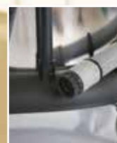
RURA SPUSTOWA DO ODPROWADZANIA ZEBRANEJ WODY
