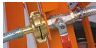
CONEXIÓN DE TOMA DE AGUA
