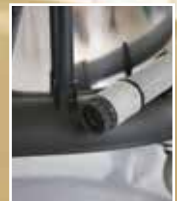
TUBO DI SCARICO ACQUA
